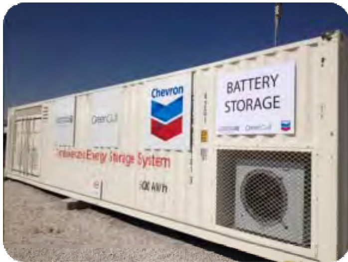
Qatar Chevron 250kW/500kWh
